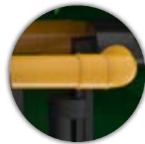
unutranji obilazni vod
